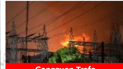
Gangguan Trafo Menyebabkan Kebakaran
