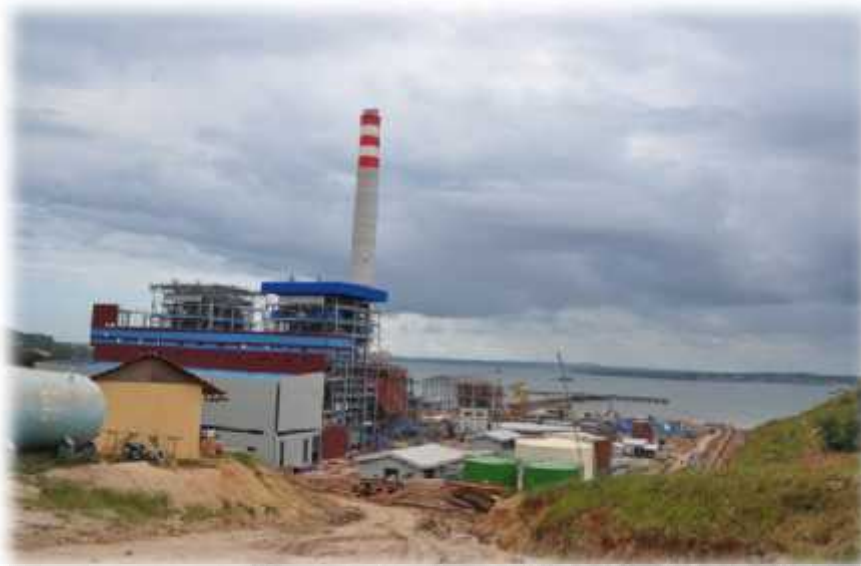
PLTU Kaltim Teluk Balikpapan 2 x 110 MW
